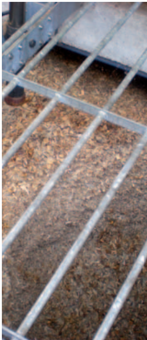
Vasca di raccoglimento del cippato del piccolo impianto a biomassa a Caldaro sulla Strada del Vino (BZ)
