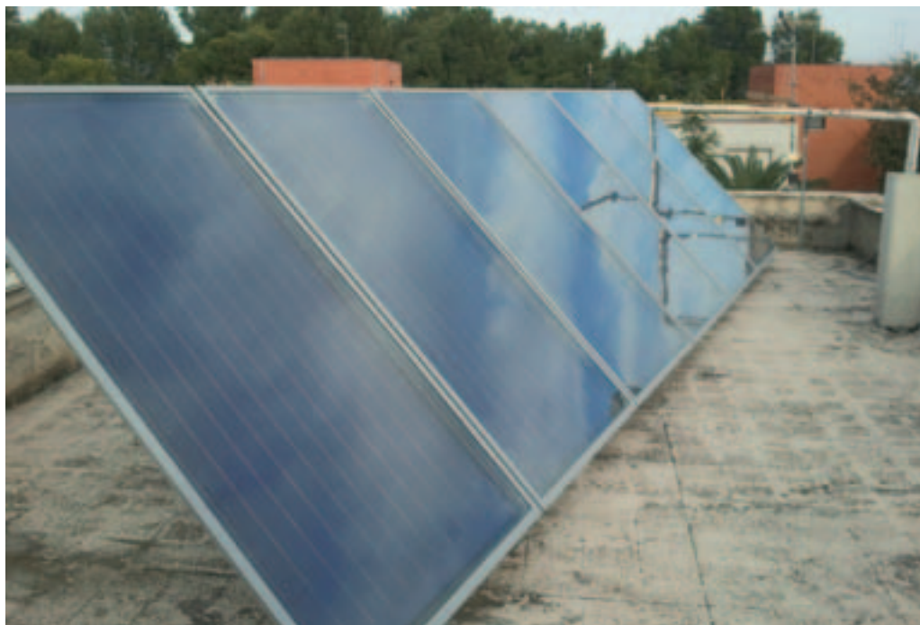
Impianto solare della Comunità di accoglienza Emmaus, Comune di Foggia
