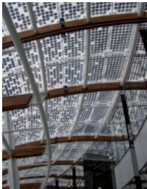
Impianto fotovoltaico integrato nella copertura, piazza Porta Nuova, Comune di Milano
