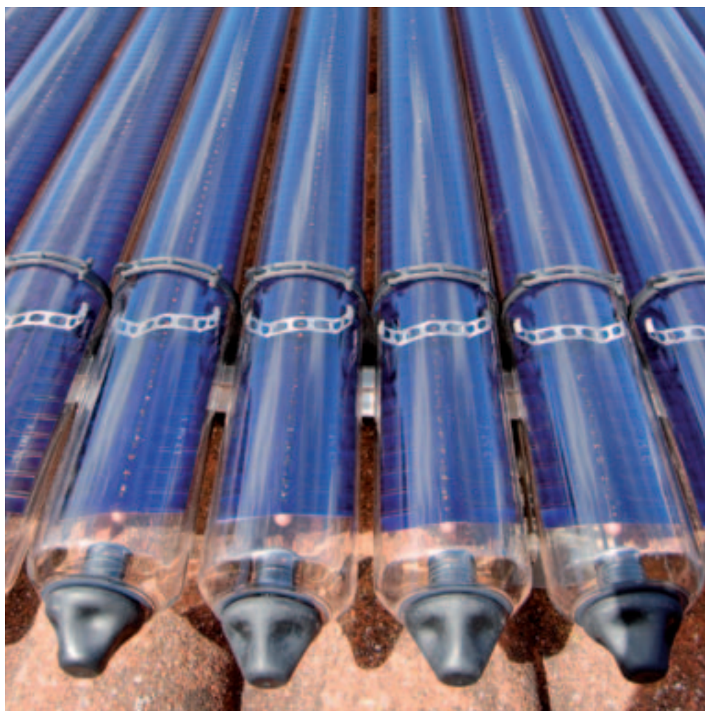
Particolare di un pannello solare termico
