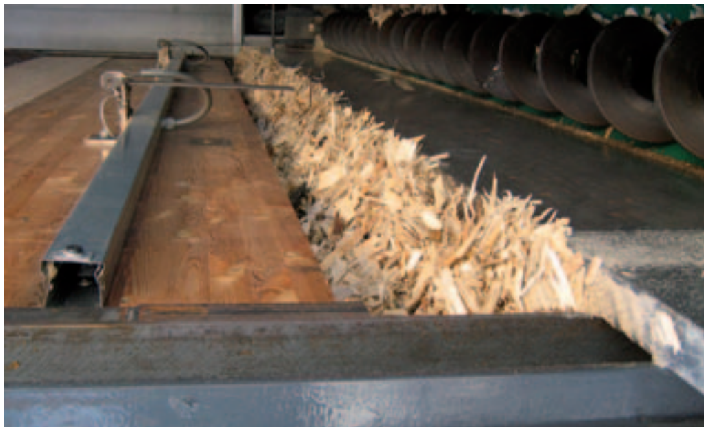
Impianto per lo sminuzzamento della biomassa solida
