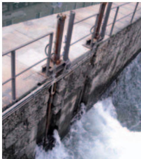
Impianto mini idroelettrico, Comune di Milano
