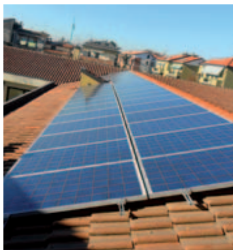
Impianto solare fotovoltaico su scuola, Comune di Piacenza
