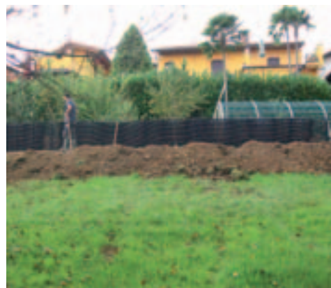
Impianto geotermico a bassa entalpia "a palizzata", Comune di Pralungo (BI)
