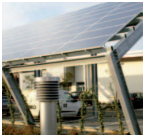
Impianto solare fotovoltaico su pensilina, Comune di Conselice (RA)
