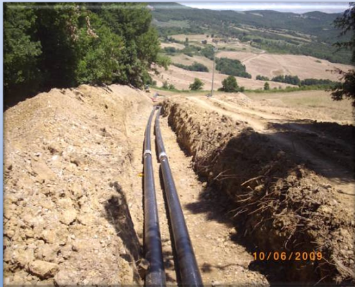
RETE TELERISCALDAMENTO - TUBAZIONI PREISOLATE INTERRATE
