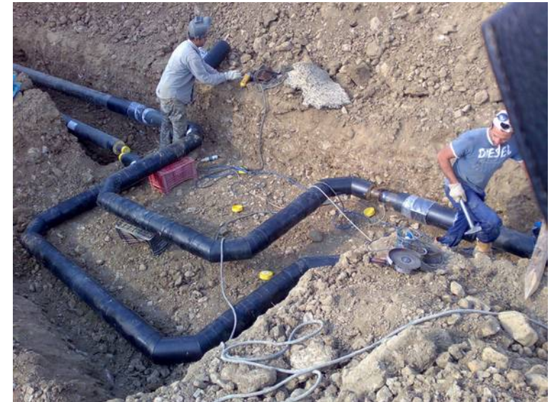
Esempio di tubazioni per teleriscaldamento
