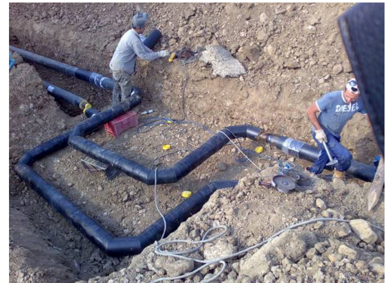
Esempio di tubazioni per teleriscaldamento
