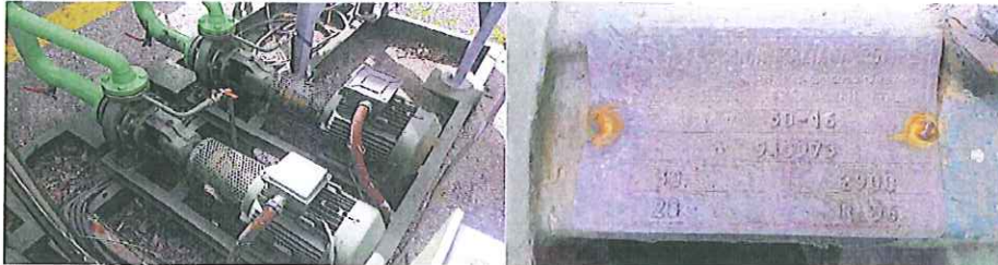
N° 2 pompa FIP
