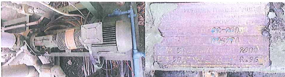
N° 1 pompa FIP
