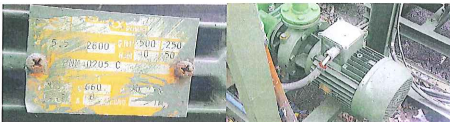
N° 1 pompa ALPHA POMPE
